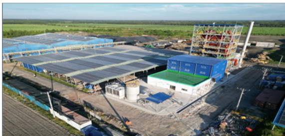
바이오매스 삼중열병합발전 플랜트 전경
